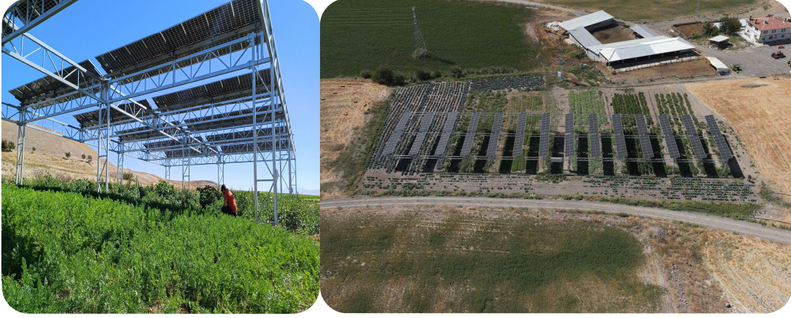
Şekil 6. Ayaş'ta bulunan TarımGES tesisine ait fotoğraflar.
