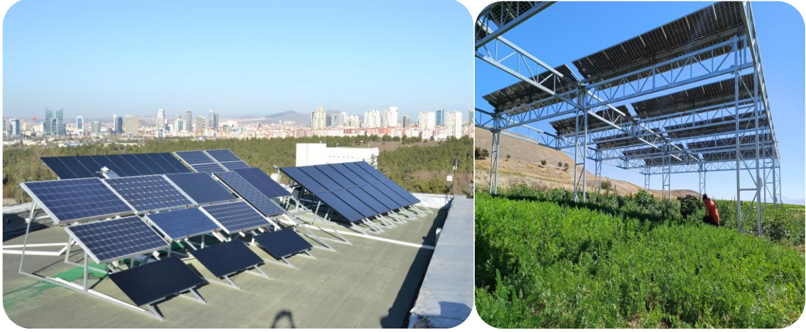
Şekil 5. Dış Mekân Test Platformunun (Sol) ve Ayaş TarımGES Tesisinin (Sağ) Görüntüsü
